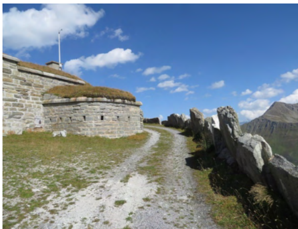
Die Anlagen des Fort Stöckli auf dem Gütsch sind baufällig.
