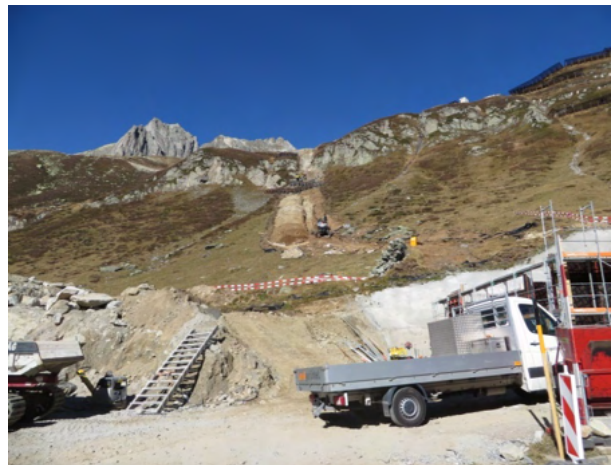
Wasserleitung ab der Pumpstation Oberalp in Richtung Vorder Felli – Schneehüenerstock.
