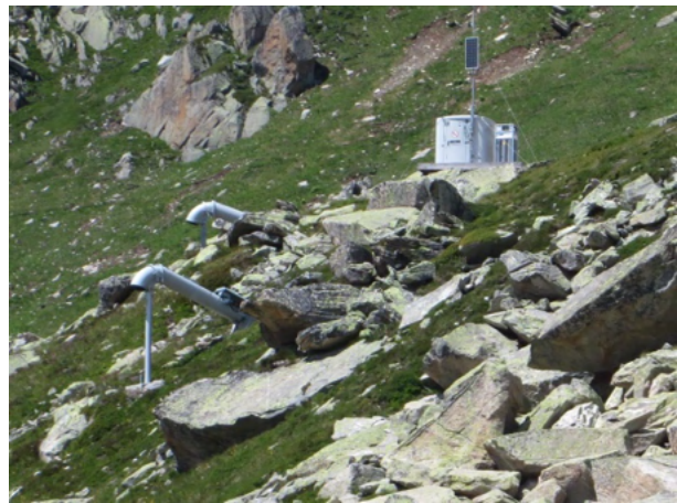
Der Impuls zur Lawinensprengung erfolgt computergesteuert über Funk.
