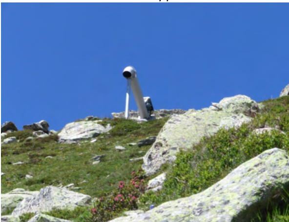
Sprengrohr einer ferngesteuerten Lawinensprenganlage.
