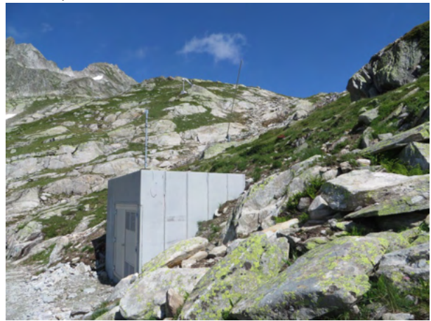
Betriebsstation an der Piste in der Region Lutersee.
